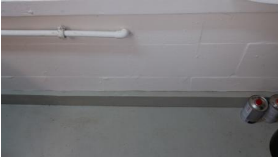
Werkstattkeller Nürnberg: Im Idealfall wird die Sockelschleife in direktem Kontakt zur Kellerwand verlegt und wenn möglich eingeputzt.
