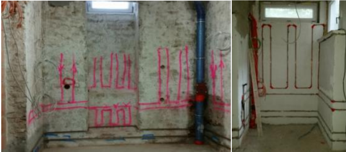
Wohnhaus Keller Siegesstraße München: Markierte Rohrverlegebereiche und installierte Temperierung in einem Kellergeschoss; Die Sockelschleife ist so konzipiert, dass ein Dauerbetrieb auch in den Sommermonaten unabhängig von der Raumtemperatur möglich wird.
